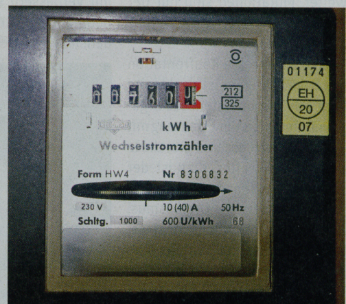
Dieser mechanische Elektrozähler wurde im Jahre 2007 geeicht und läuft 2023 nach 16 Jahren ab.
